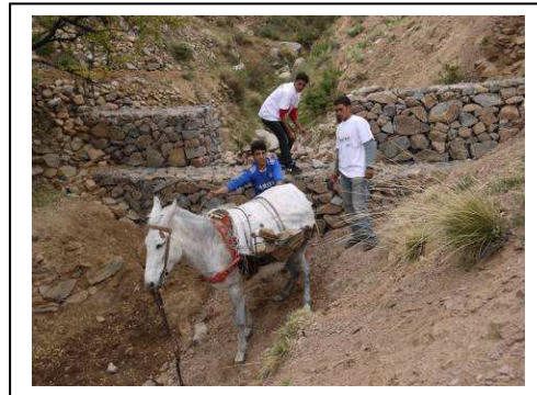
Jeunes hommes du village participant à l'aménagement d'un ravin pour la lutte contre l'érosion (photo Bruno Deceukelier/UNDP-GEF CBA)
