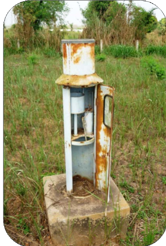
Figure 7.1 : Pluviomètre en panne
